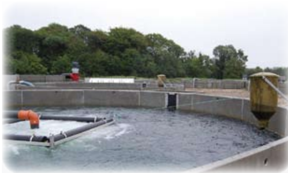
Bassin med belufter
